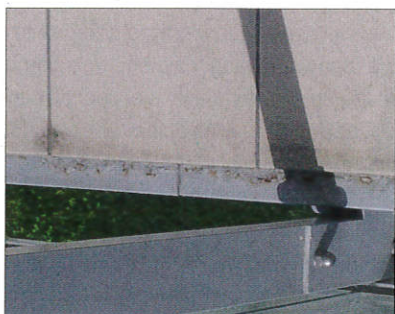
Fot. 2 | Korozyjne obróbki blacharskie
