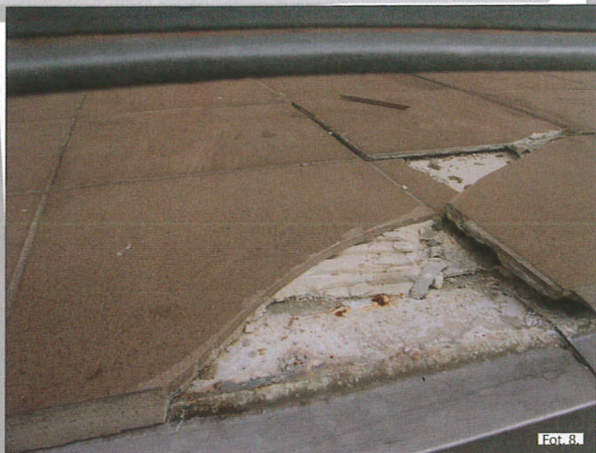
Uszkodzenia okładziny w strefie okapu
