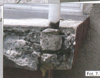
Fot. 5, 6, 7 – Zaawansowane uszkodzenia brzegów płyty konstrukcyjnej
