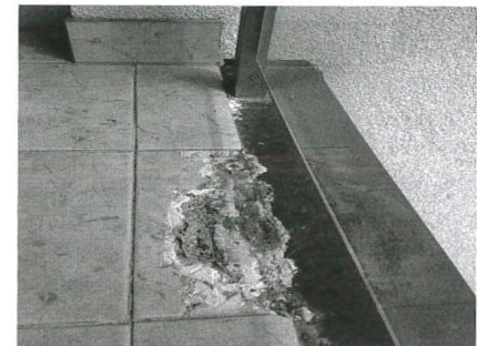
Fot. 2. Korozja okapnika zamocowanego w warstwie hydroizolacyjnej
