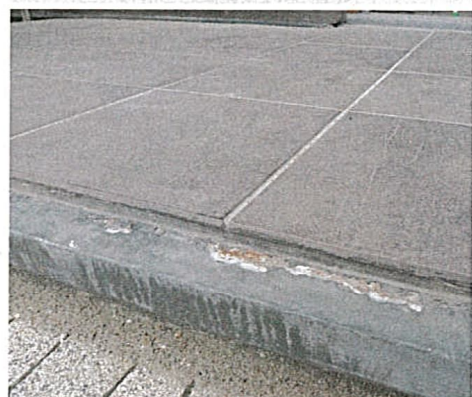
↑ Wilgoć i woda gromadzące się na nierównościach blachy powodują jej powolną degradację
