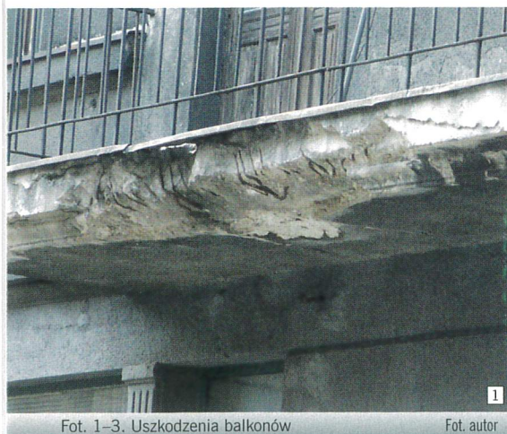
Fot. 1–3. Uszkodzenia balkonów
